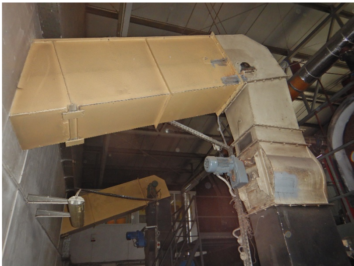
Fot. 9 Widok systemu dostarczania paliwa do modernizowanego kotła
